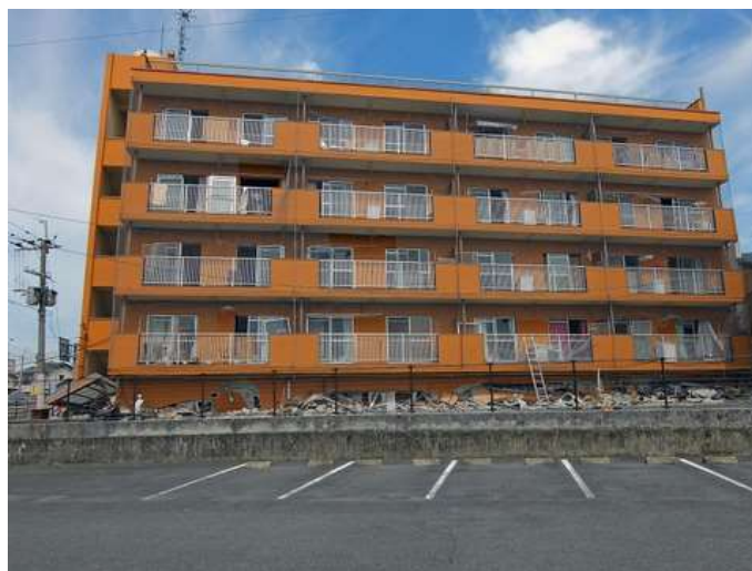
益城町へ行く途中の共同住宅鉄筋コンクリート造で1階が倒壊、2階以上があまり被害がない。
